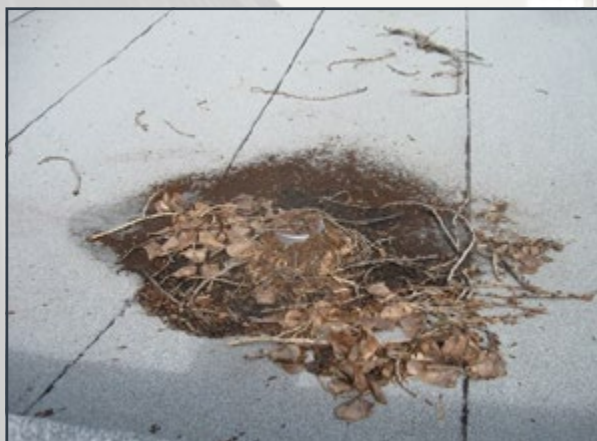
Drain obstrué à nettoyer
