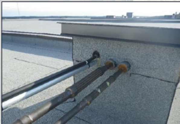
Calfeutrant à surveiller
