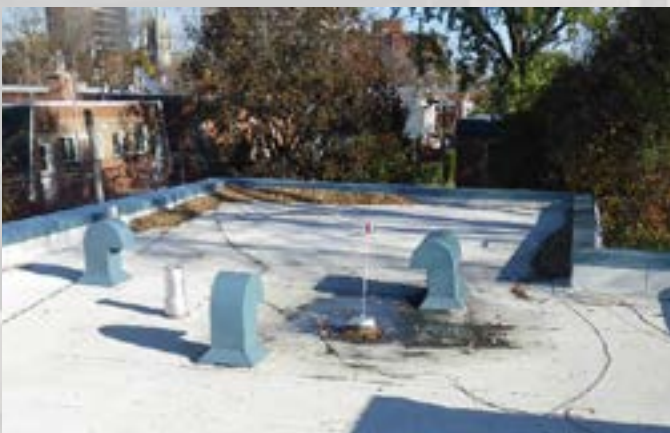
Débris pouvant obstruer le drain
